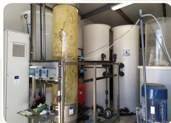
Vista de la planta piloto.
